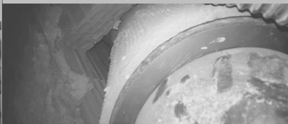
Conectare greșită a conductei de gaze arse și nu există nicio dilatare a absorbției de fum
